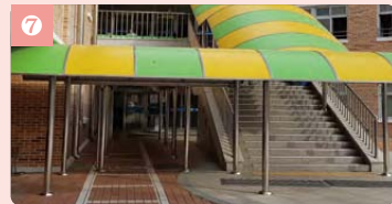
7 외부 계단 렉산 지붕(기둥) 설치 ▶ 접근로 및 계단 손잡이 기준 부적합
