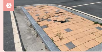
2 접근로 파손 ▶ 접근로 기준 부적합
