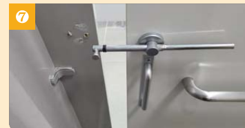
7 잠금장치 파손 ▶ 장애인들의 화장실 이용 불가
