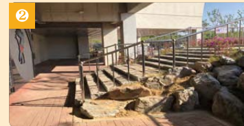
2 외부 & 내부 계단 신설 ▶ 계단의 기준 부적합
