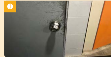
1 신설된 출입문의 기준 미확보 ▶ 출입문(손잡이, 유효폭)기준 부적합
