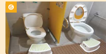
6 화장실 변경 공사 ▶ 장애인들의 화장실 기준 부적합
