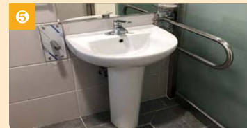
5 손잡이 파손 및 세면대 덮개 설치 ▶ 위생시설 기준 부적합
