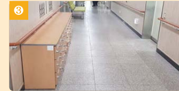
3 가구 등 보행장애물 설치 ▶ 복도 기준 부적합
